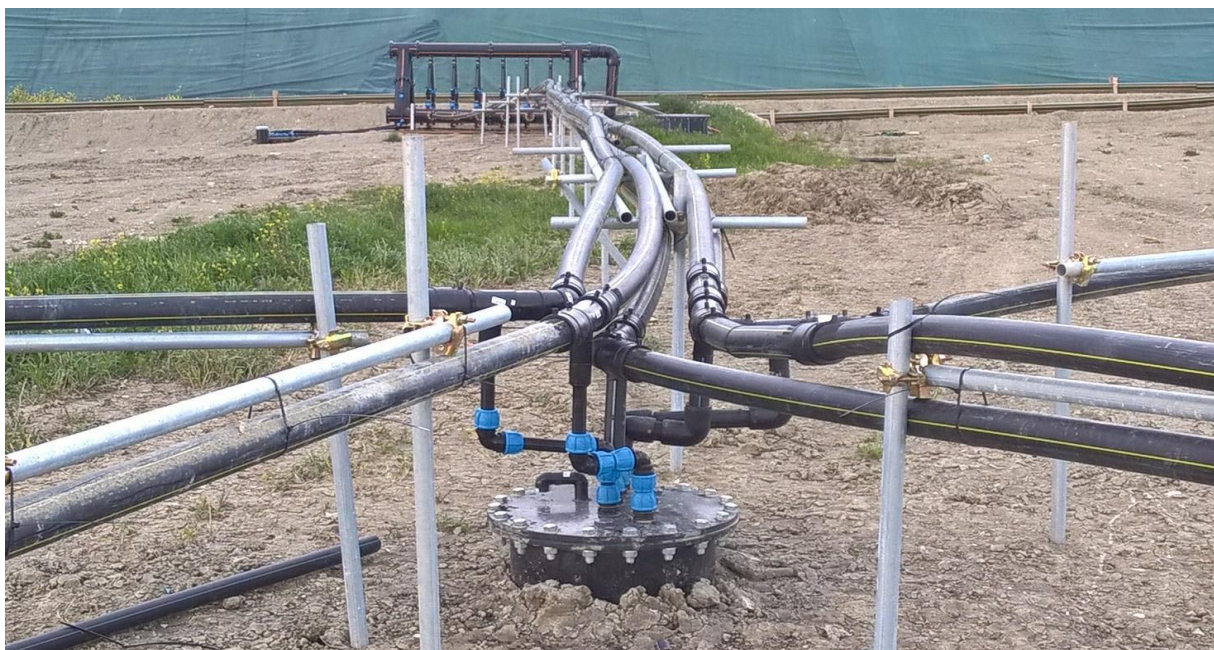
Rysunek 4.6. Linie wtórnego gazu składowiskowego ułożone na podporach z rur metalowych - na pierwszym planie zrzutnia kondensatu - w tle Stacja Regulacji. Source: ASET Spa, Nov.2020.
