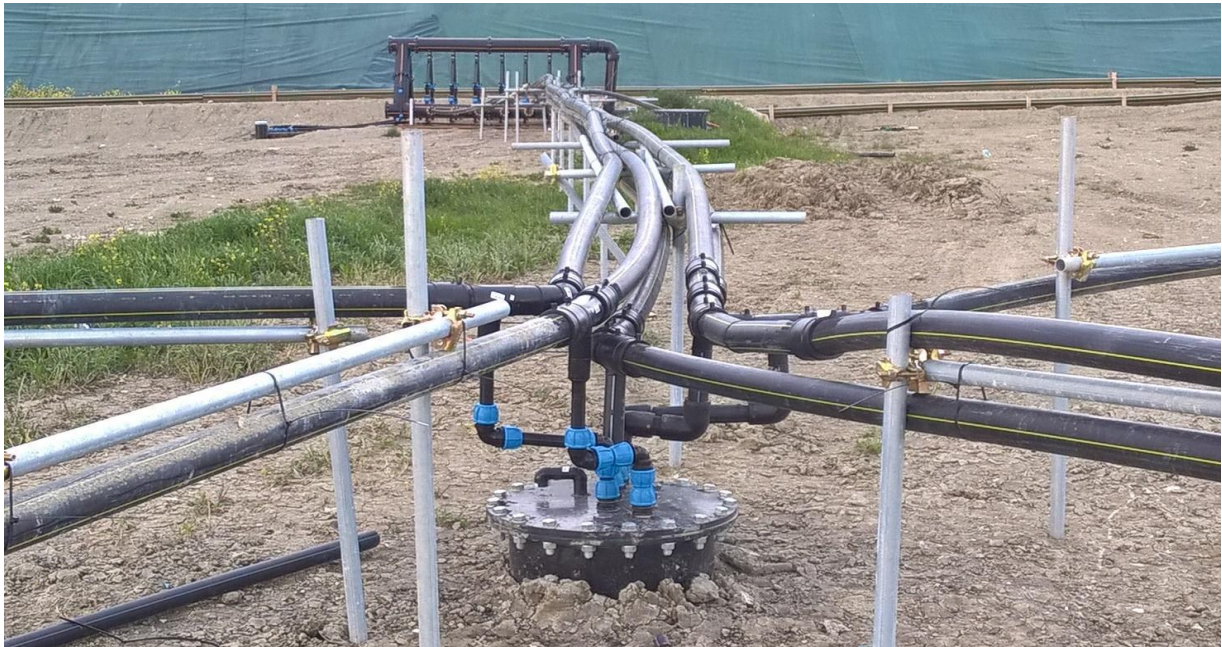
Figura 4.6. Conducte secundare de gaze la depozitele de deșeuri așezate pe suporturi de țevi metalice - în prim plan un evacuator de condens - în fundal o Stație de Reglementare. Sursa: ASET Spa, nov.2020.
