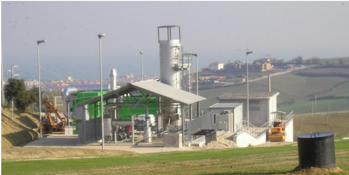
Figura 4.7. Instalatie de extractie si valorificare energetica a gazelor de depozit. Sursa: ASET Spa, 2005.
