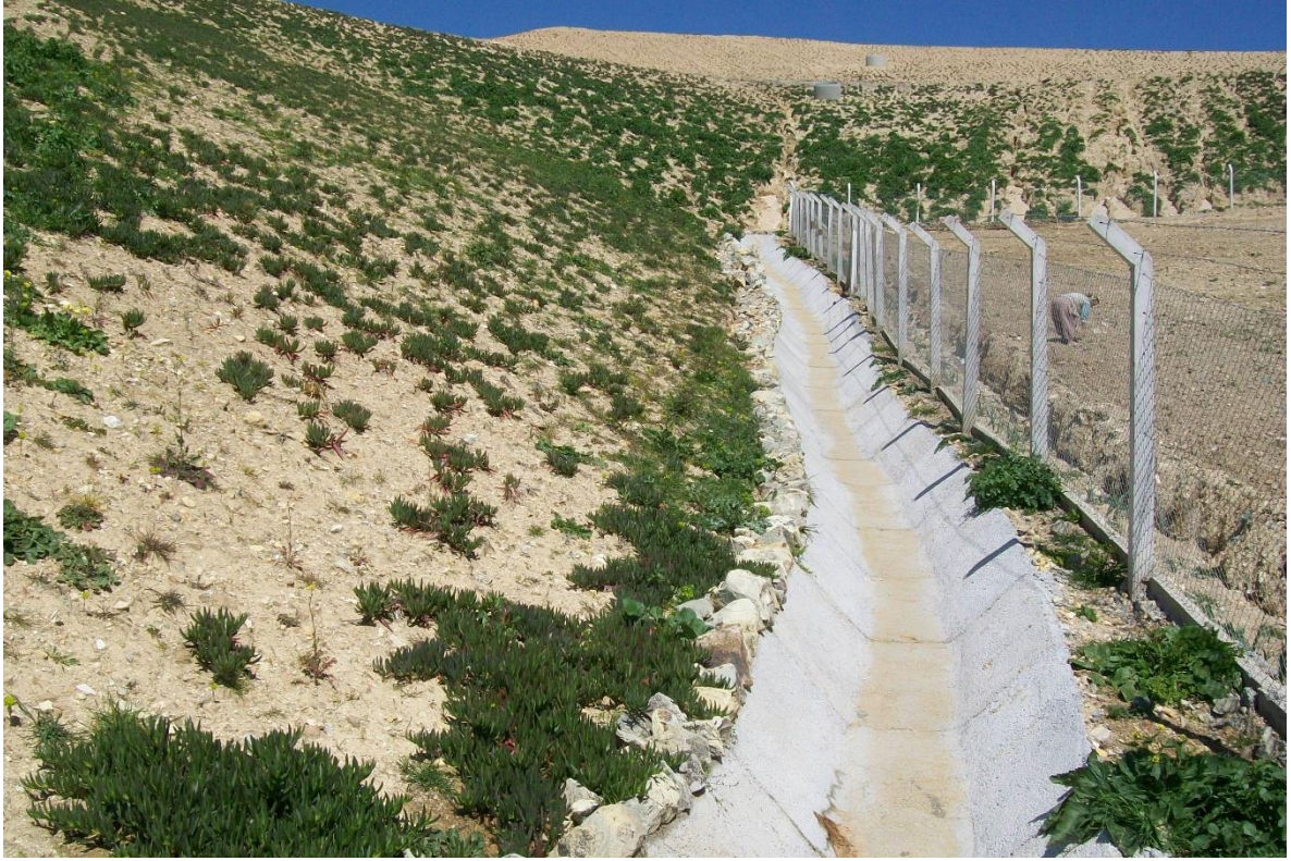
Şekil 3.9. Yüzey suyu toplama kanalı.
