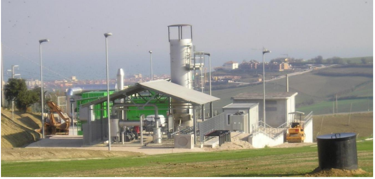
Şekil 4.7. Depolama sahası gazına yönelik Ekstraksiyon Tesisi ve enerji kazanımı. Kaynak: ASET Spa, 2005.
