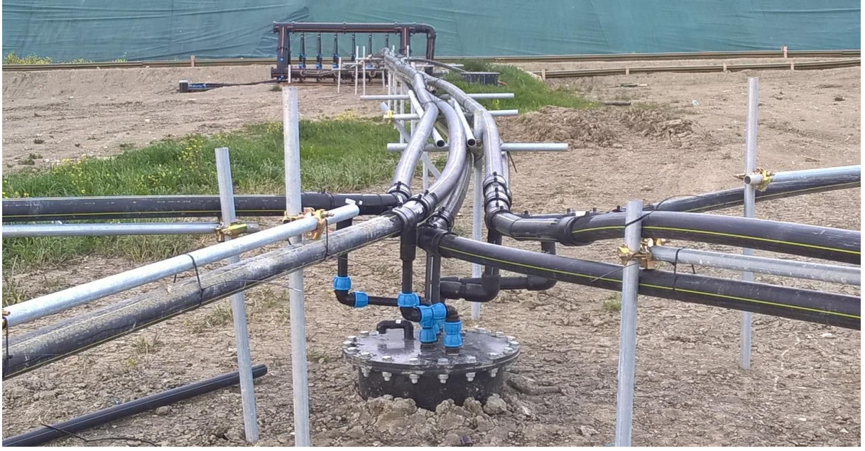
Şekil 4.6. Metal boruların taşıyıcıları üzerine yerleştirilmiş olan ikincil depolama sahası gazı hatları – ön planda kondensat deşarj cihazı, arka planda bir Düzenleme İstasyonu yer almaktadır. Kaynak: ASET Spa, Kasım 2020.
