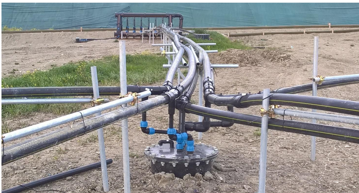
Figura 4.6. Linee secondarie biogas posate su supporti di tubi metallici – in primo piano uno scaricatore di condensa – sullo sfondo una Stazione di regolazione. Fonte: ASET Spa, Nov.2020.
