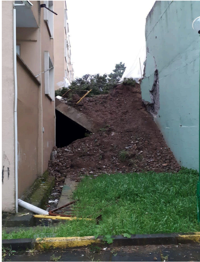
Figura 3.18. Muro di sostegno crollato e frana (o movimento di massa).
