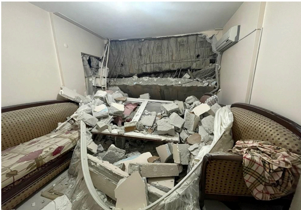
Figura 3.19. Una stanza il cui muro è crollato a causa di una frana.
