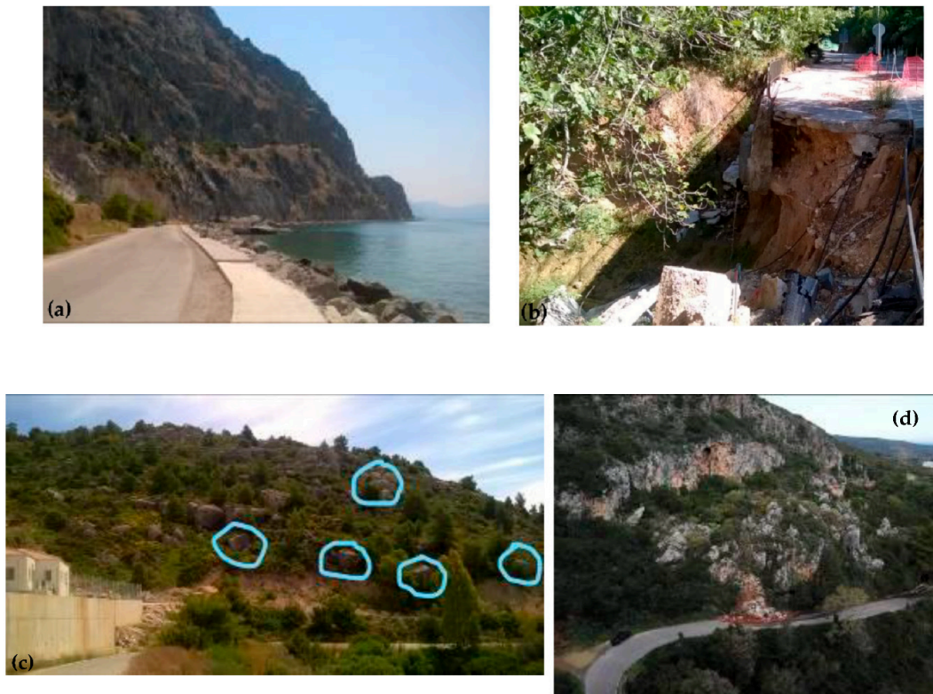
Figura 6.7: (a) Aree costiere di Alepochori–Psatha nell'Attica nord-occidentale interessate da frane, (b) Il torrente Chelidonous nel comune di Kifisia (a nord di Atene) provoca frane sui pendii delle sponde. (c, d) Le isole Spetses e Kithira in Attica sono interessate da cadute di massi. I cerchi azzurri vengono utilizzati per enfatizzare l'elevata probabilità di caduta massi.
