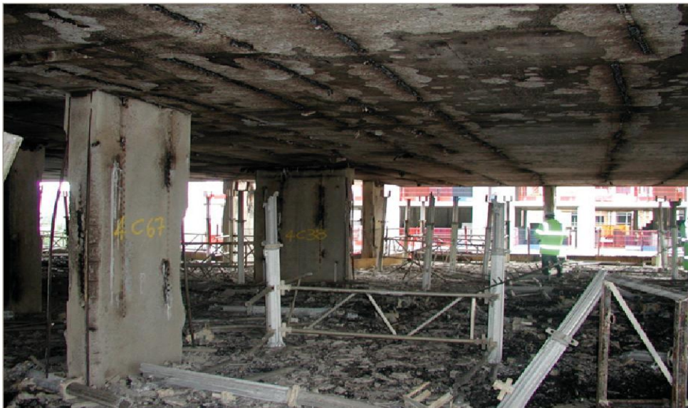
Εικόνα 4.10. Πυρκαγιά σε κτίριο οπλισμένου σκυροδέματος
