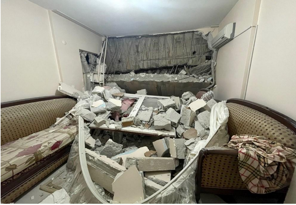
Şekil 3.19. Heyelan nedeniyle duvarı çöken bir oda.
