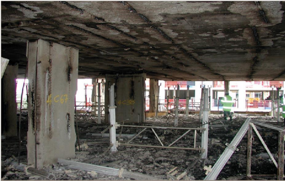
Şekil 4.10. Yangının hasar verdiği beton yapının içten görünümü.
