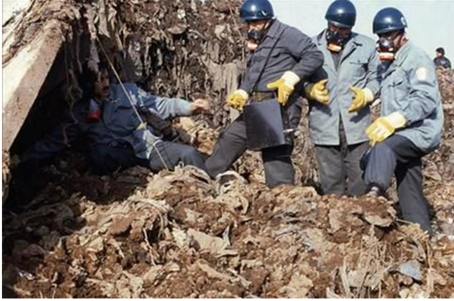
Şekil 1.5. Hekimbaşı vahşi depolama alanında meydana gelen patlama sonrası kurtarma çalışmaları
